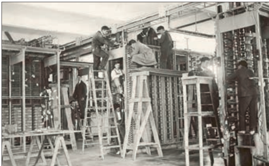
Imagen de Samot de 1926 en la que se ve la instalación de los bastidores de la central telefónica en Santander.
