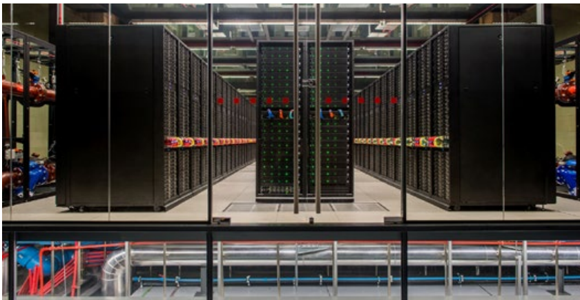
Vista trasera junto con el mecanismo de alimentación y refrigeración del superordenador MareNostrum 4. [Fuente: BSC].
