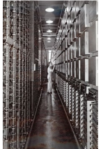
El equipo Rotary de Gran Vía, hacia 1968. La imagen transmite a la perfección la sensación de orden de estas salas. Puede verse a un mecánico trabajando en uno de los cuadros, empujándolo por la escala del equipo. Este espacio no se hizo para el ser humano sino para la máquina.
