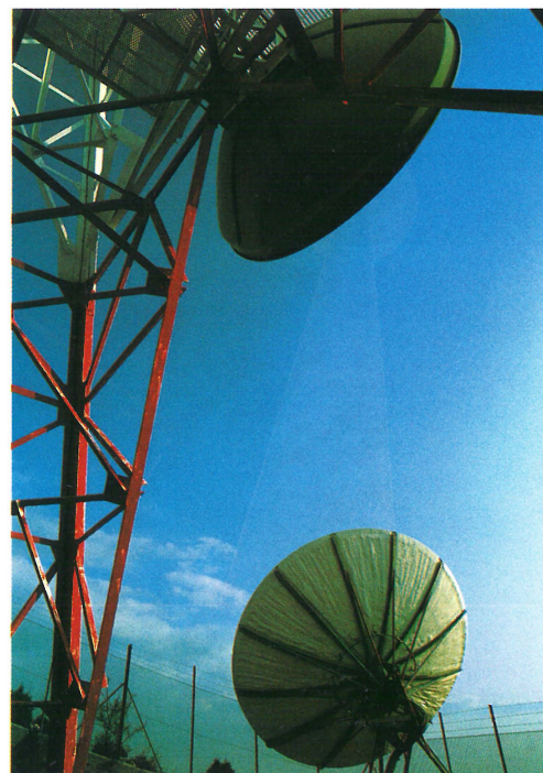
Parábola terrestre y de satélite en la estación de transmisión de Argüis (Huesca)
