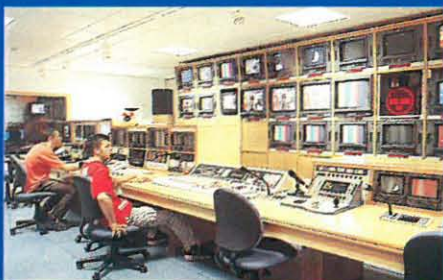
Centro de Producción de programas y emisión automatizada del Canal Disney en España (Telson Canales Temáticos).
