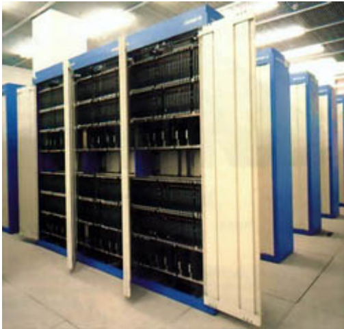
Fig. Central de 10.000 líneas del Sistema 12 - instalada en Salamanca.
